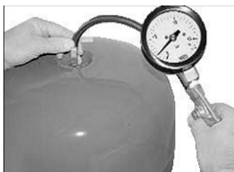
Рис. 6 Контроль давления в мембранном баке
